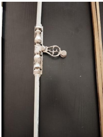
Рисунок 11. Состояние длинного шпингалета (кремоны) до реставрации
