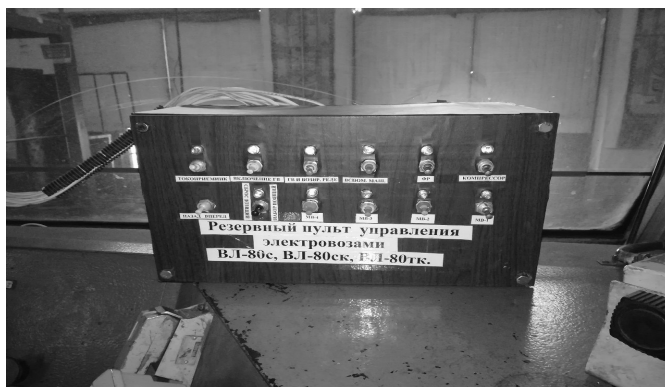
Рисунок 5. Резервный пульт управления электровоза ВЛ-80с, ВЛ-80ск, ВЛ-80тк
