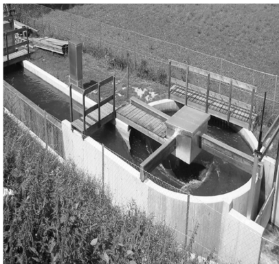
Рисунок 18. Вихревая водяная электростанция, автор проекта и строитель Franz Zotloterer
