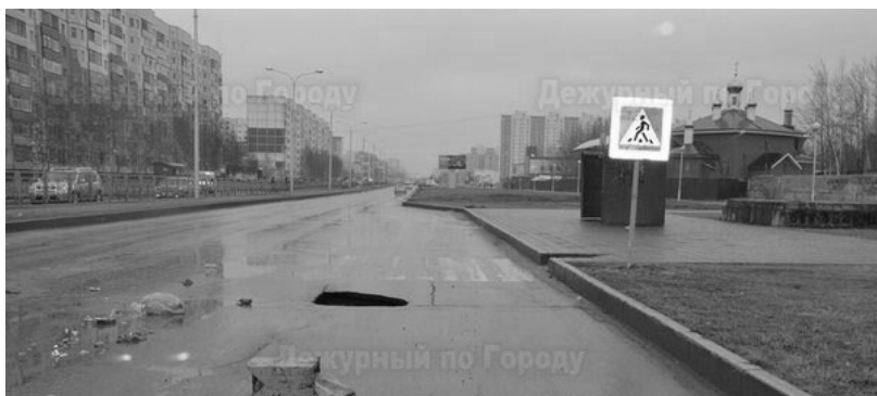
Рисунок 4. Обрушение дороги в Нижневартовске, 2018 г.
