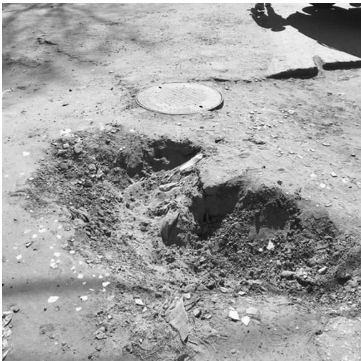
Рисунок 5. Просел грунт в жилом районе г. Нижневартовск, 2019
