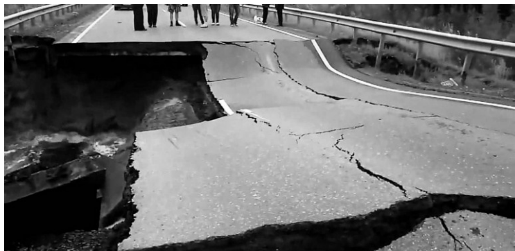
Рисунок 3. Обрушение моста на трассе Тюмень - Ханты-Мансийск
