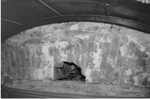
Рисунок 1. Фасад по Невскому проспекту. Перемычка дверного проема. Фрагмент срубленного сандрика первоначального окна
