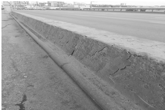
Рисунок 3. Отслаивание верхнего слоя цементобетонного покрытия от поверхности ограждения на Коммунальном мосту г. Новосибирска
