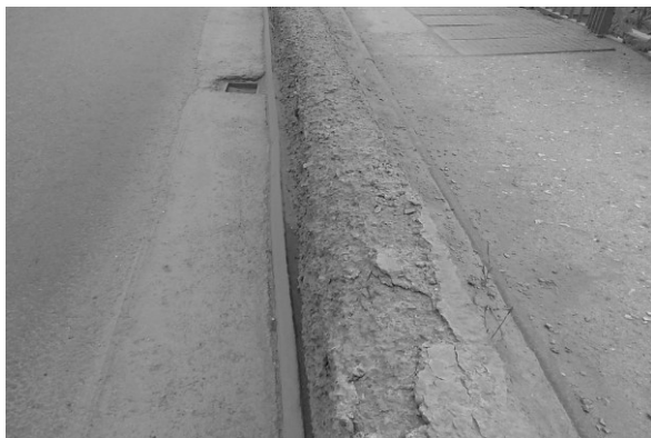
Рисунок 4. Шелушение поверхности цементобетонного ограждения на Коммунальном мосту г. Новосибирска
