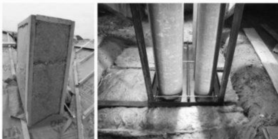
Рисунок 3. Вентиляционный канал из асбестоцемента
