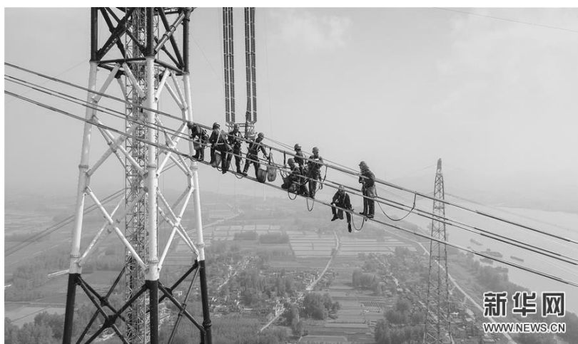
Рисунок 7. Фрагмент линии электропередачи с напряжением 1100 киловольт в Китае
