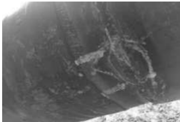
Рисунок 1. Сварочная трещина в газопроводе высокого давления
