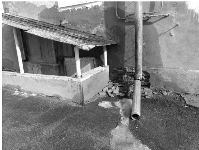
Рисунок 1. Последствия воздействия воды на строительные конструкции. Неправильная система водоотведения. Капиллярный подсос по штукатурке
