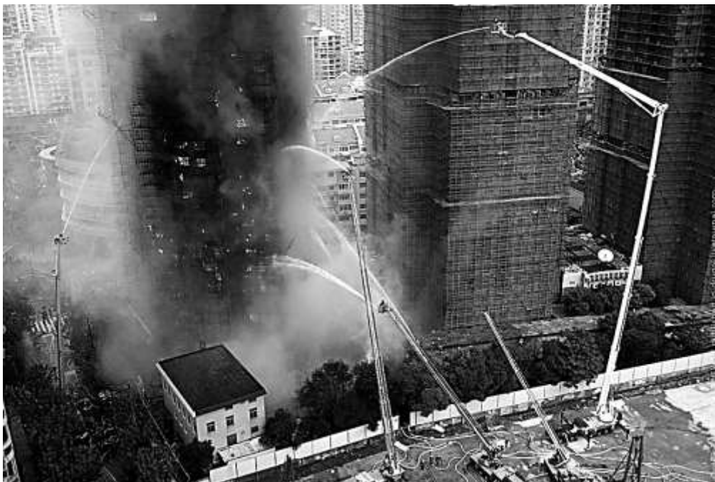
Рисунок 2. Пожар в строящемся здании в Шанхае (Китай)
