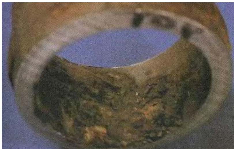
Рисунок 1. Разрушение трубы в результате выедания металла при низком pH
