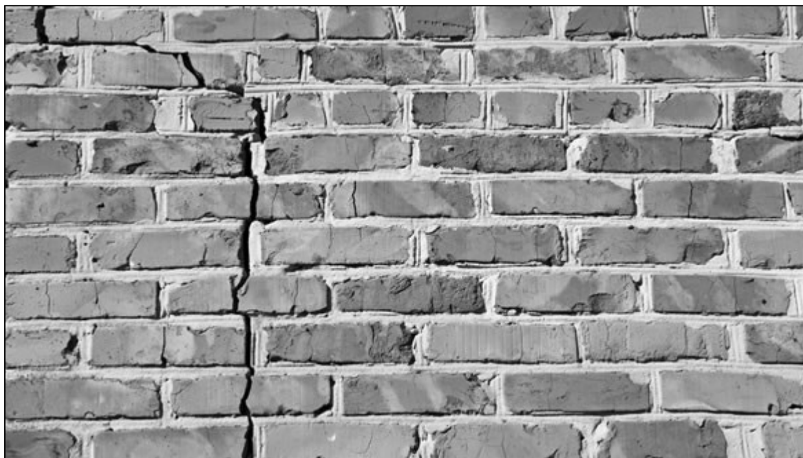
Рисунок 4. Вертикальные щели в каменной кладке
