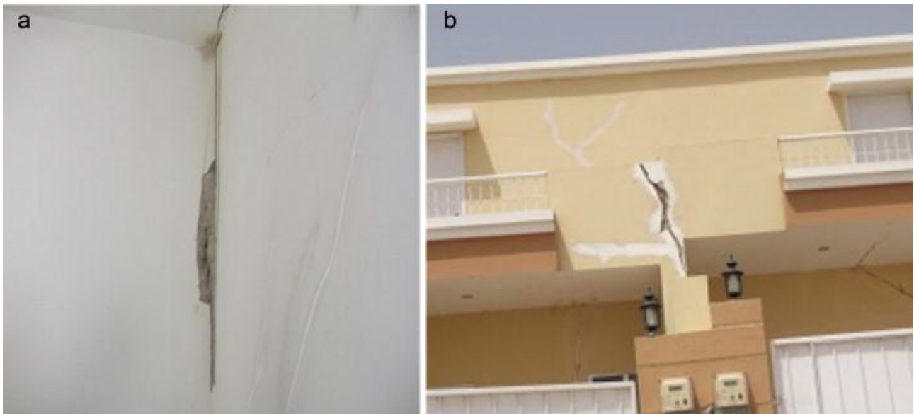
Рисунок 1. Трещины на исследуемых зданиях
