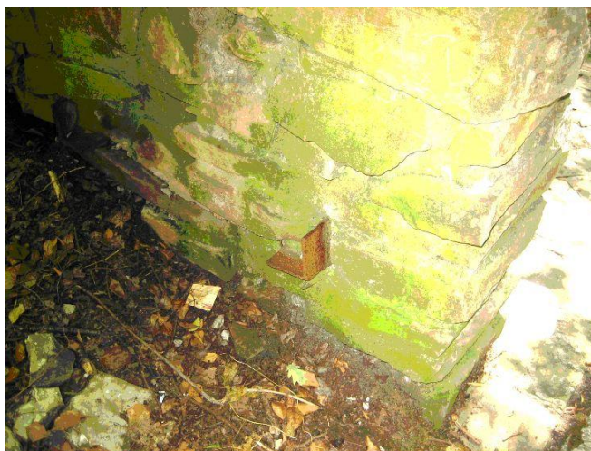
Рисунок 2. Стена здания, подверженная биокоррзии
