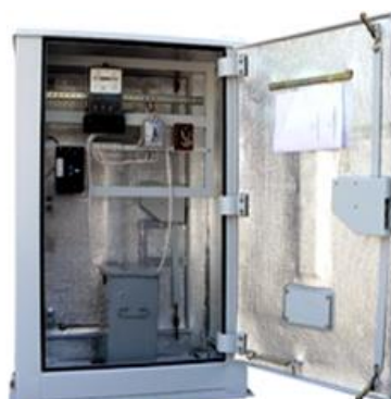
Рисунок 4. Шкаф для подключения путевого электроинструмента ШПЭ
