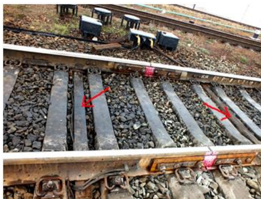
Рисунок 3. Деревянные бруски в шпальных ящиках
