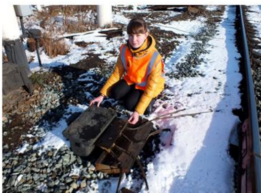
Рисунок 1. Защита выводов дроссель-трансформатора 2ДТ
