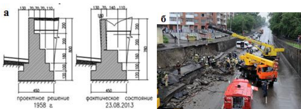
Рисунок 2. Разрушение подпорной стены на проспекте Свободный: а) анализ состояния на 23.08.2013; б) разбор завалов после разрушения
