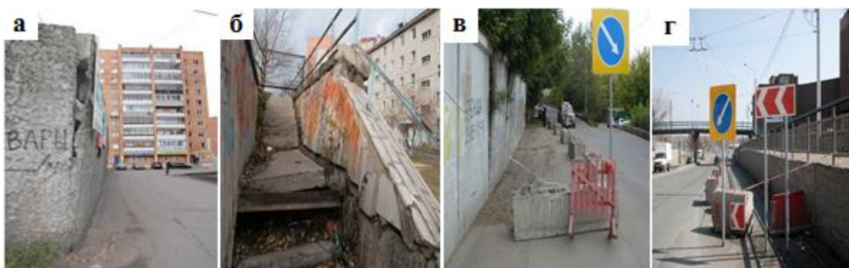
Рисунок 3. Подпорные стены, находящиеся в аварийном состоянии: а) ул. Петра Слоцова, 4; б) ул. Гусарова, 14; в) пер. Боготольский, 6; г) ул. Карла Маркса, 6
